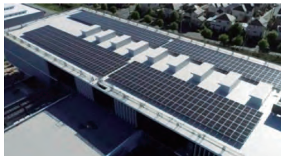
神戸サイエンスパークセンター事務棟の屋上全面に設置されている太陽光発電
